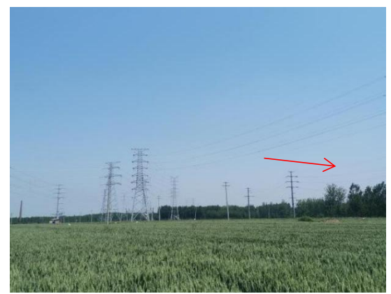
110kV石烟/长杜双回架空线路，长杜线3#~4#东侧衰减
