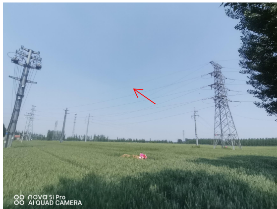
110kV长和线单回架空线路16#-17#西南侧衰减
