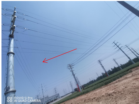
110kV石烟单回线路73#~74#北侧衰减
