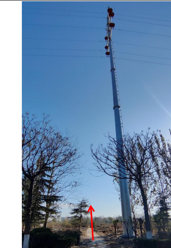
110kV 庞固线 51#~52# (110kV 孙固线 37#~38#) 杆塔之间双回架空线路东侧衰减
