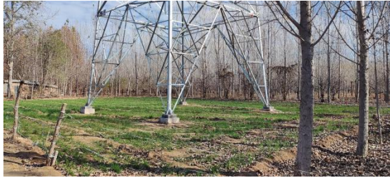
II 接处 110kV 孙固线 30#附近材料临时存放场地 地面恢复情况
