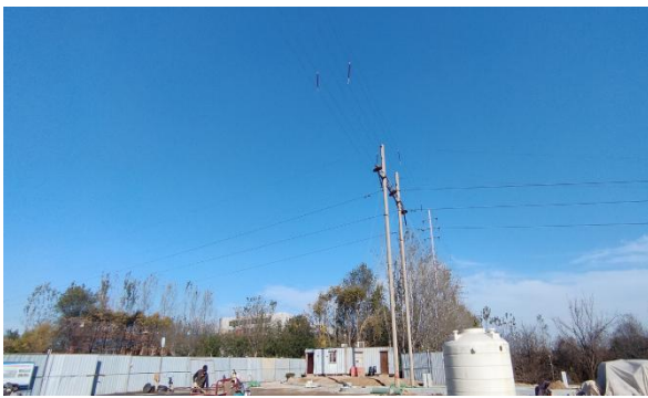
M3.110kV 庞固线 53#~54# (110kV 孙固线 39#~40#) 杆塔之间边导线线下施工板房
